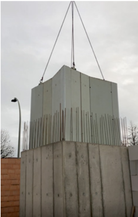
Abb. 95: Klappschacht am Kran
